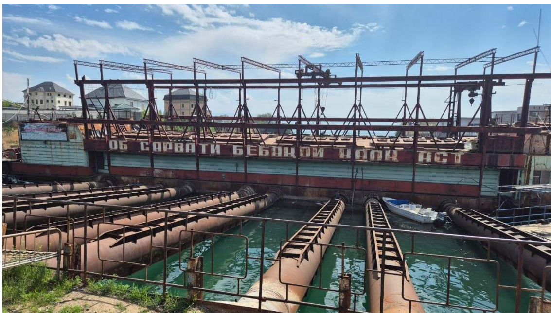
Плавучая насосная станция Сомгор-1
