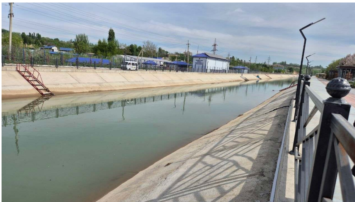
Бетонированный участок русла БНК
